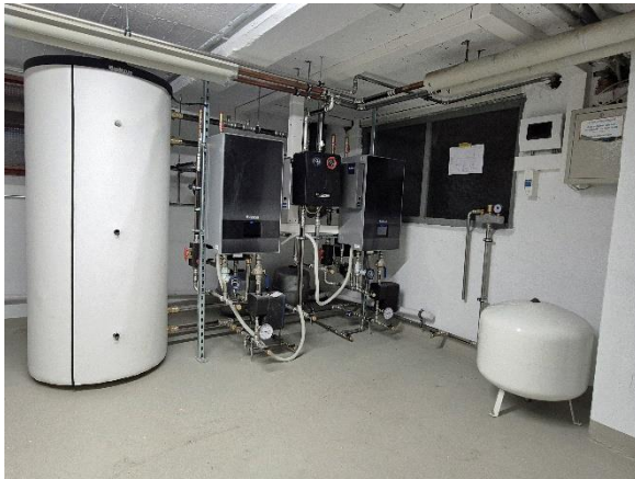
Luftwärmepumpe An den Bleichen 8 - 10
