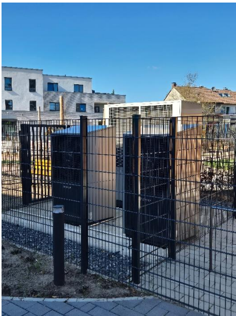
Luftwärmepumpen für das Gesamtobjekt
